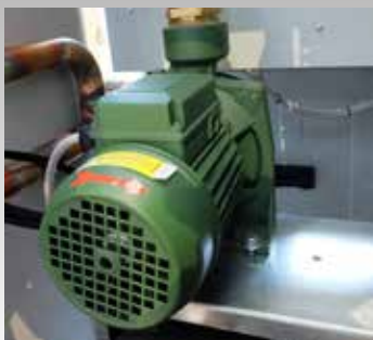
Pompa de circulatie - Circulating pump
